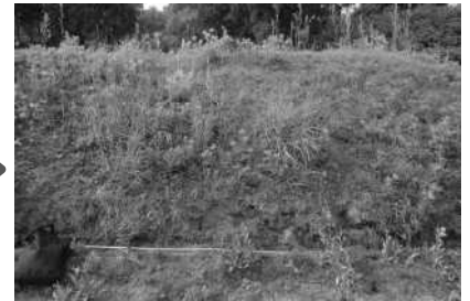
地割れの様子。法面の改修には、表土を削って土を盛りなければならない。
