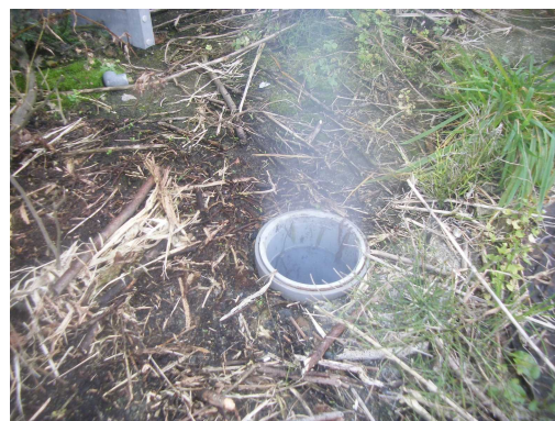
【管渠破損状況】
