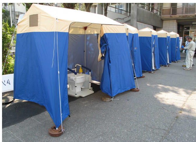
【マンホールトイレ設置状況】
