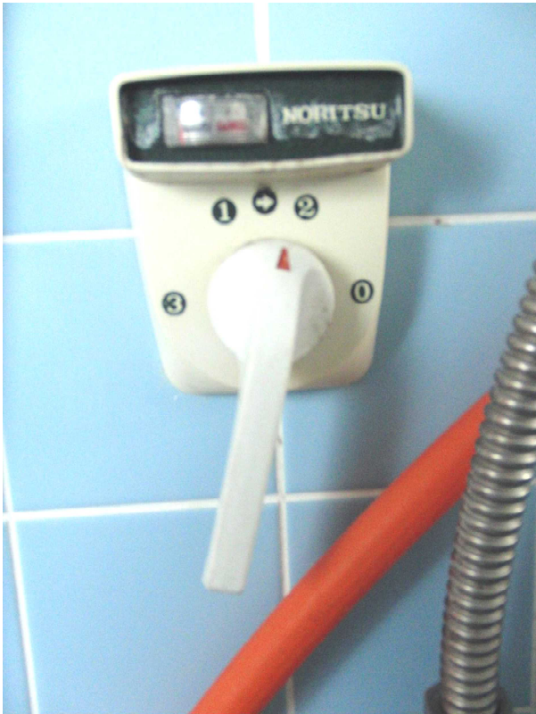
【1階浴室ボイラースイッチ】
