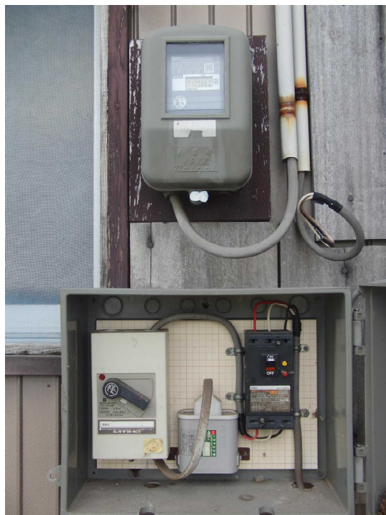
【電気メーター】
