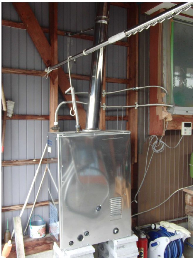
【1 階倉庫内給湯器】
