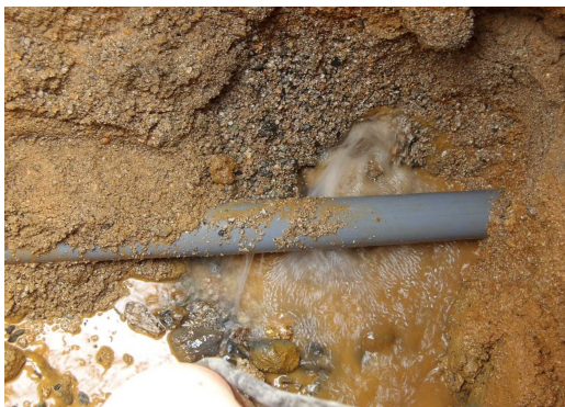
硬質塩化ビニル管 漏水状況
