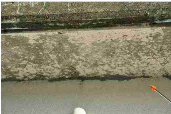
屋根吹付塗材の劣化・剥離・剥落（全体）
