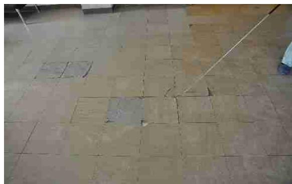
床タイルの劣化・破損・剥離（全体）
