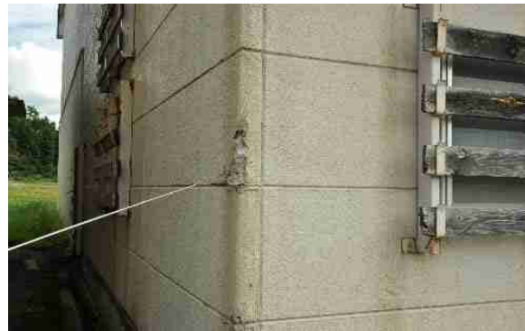
外壁コンクリート板の破損
