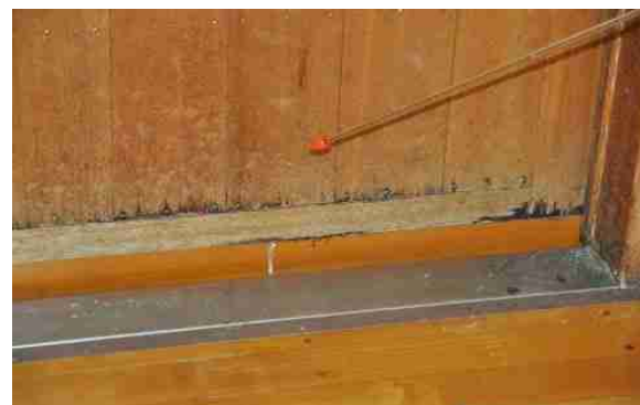
木製建具の漏水跡
