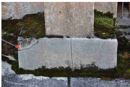
基礎のひび割れ・剥離（多数）
