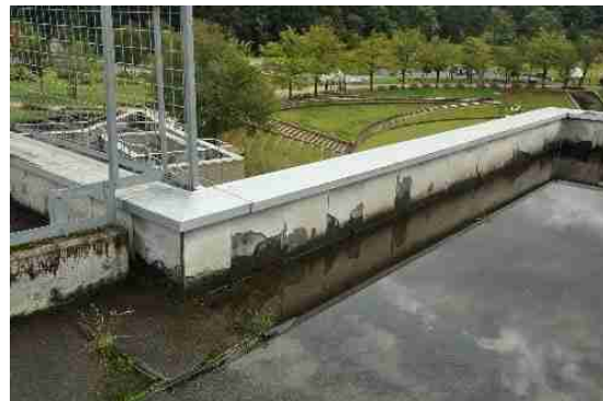
パラペット保護ボードの劣化(全体)
