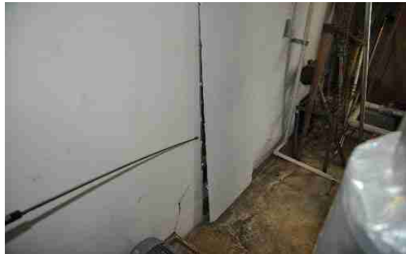
内壁ボードの破損
