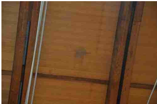
アリーナ上部の漏水跡
