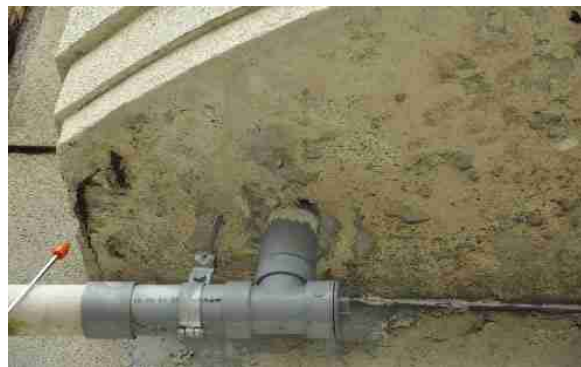
外壁吹付塗材の剥離・剥落
