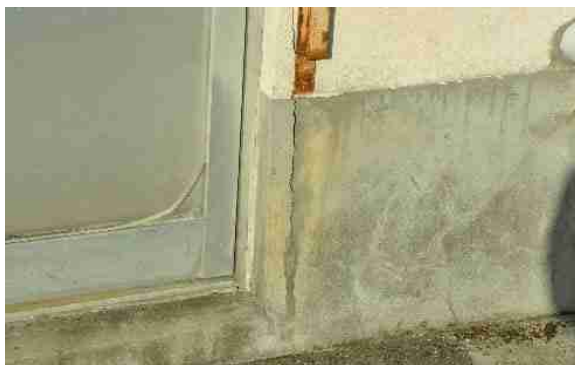
基礎のひび割れ（全体多数）
