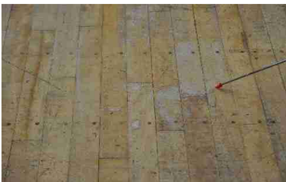
床フローリング材の劣化・摩耗（全体）
