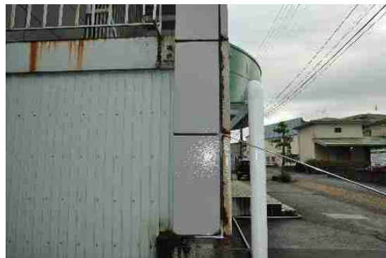
外壁金属板の発錆・シーリング材の劣化
