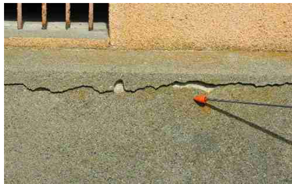
基礎モルタルのひび割れ・剥離・剥落
