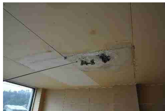
天井材の漏水跡・損傷
