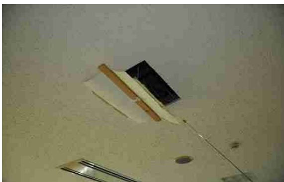
雨水の浸水と仕上材の破損
