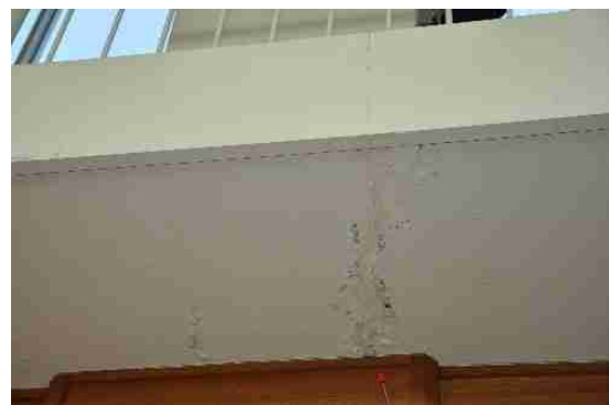
キャットウォークのひび割れ・塗膜劣化
