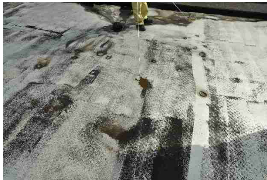
塗膜防水の破損（多数）
