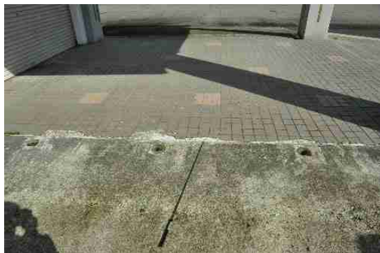
床タイルの割れ・破損
