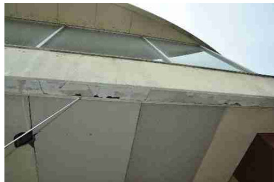
下がり壁のコンクリート剥落
