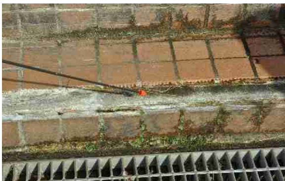
階段ノンスリップタイルの脱落（多数）
