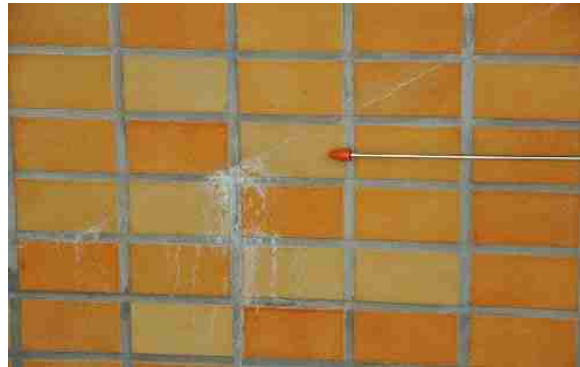
外壁タイルのひび割れ・白華
