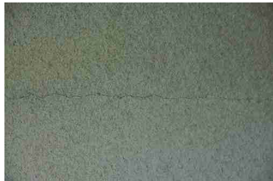
外壁のひび割れ（全体多数）
