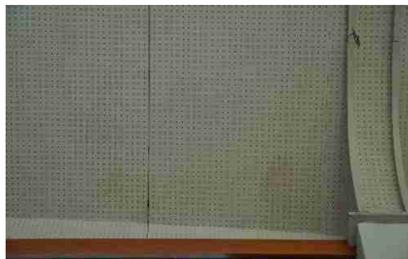
天井の雨漏り跡（多数）
