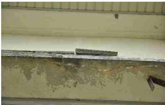
庇のひび割れ・剥離剥落・白華
