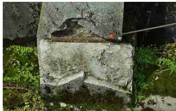
基礎モルタル剥落・ベースプレート発錆
