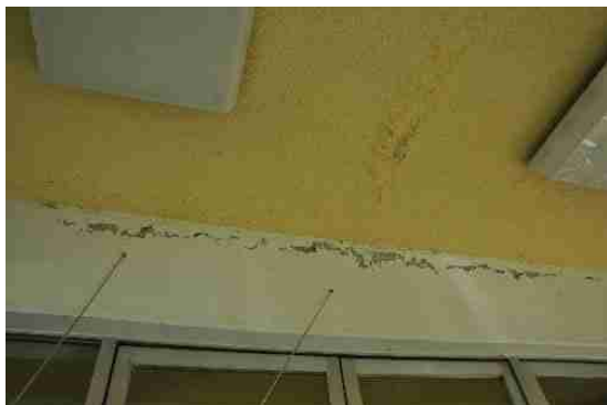
吹付塗材の劣化・剥離・剥落(全体)
