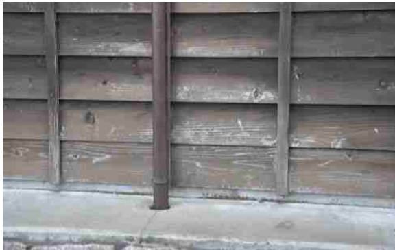
押縁下見板の変色
