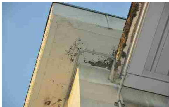
吹付け塗材の劣化・剥離・剥落
