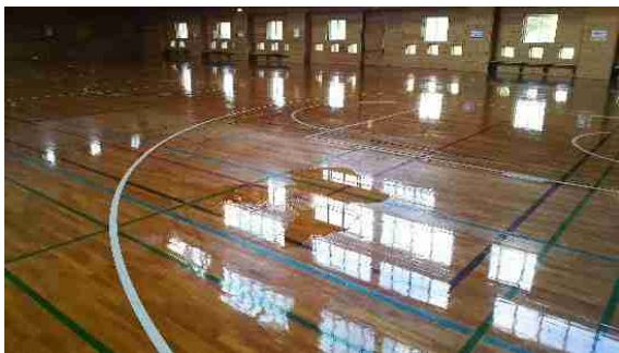
アリーナ内の雨漏りによる水溜まり
