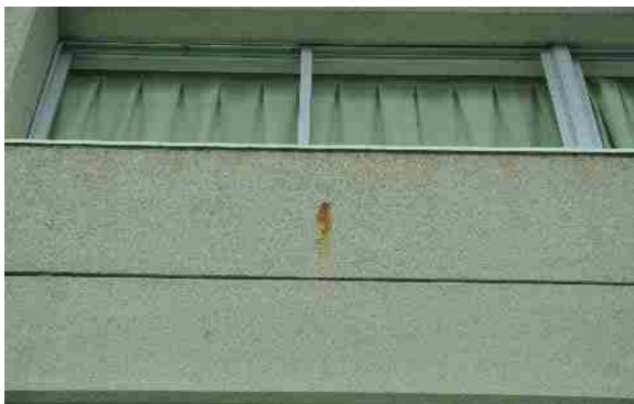
外壁コンクリートの爆裂欠損・錆汁
