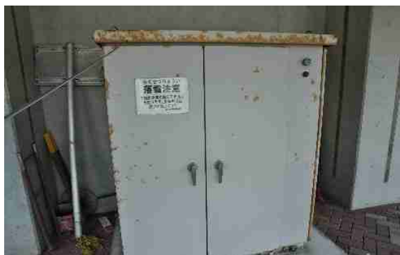
浄化槽保安箱の発錆
