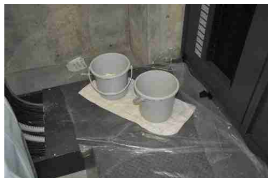
屋根雨漏り（4 F 上部調光盤室）
