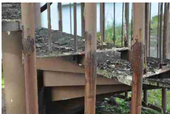
鉄骨避難階段の劣化・発錆・腐食
