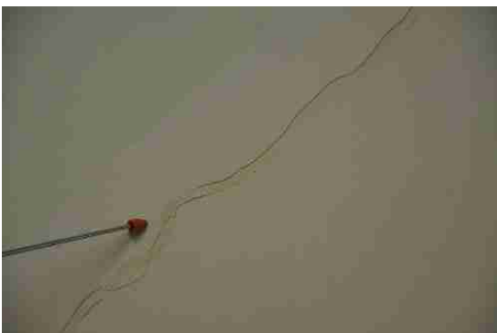
内壁にひび割れ
