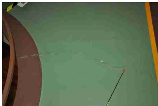
ランニング通路 床のひび割れ
