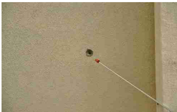
外壁の爆裂欠損（多数）
