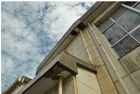
屋根葺材の発錆（全体）
