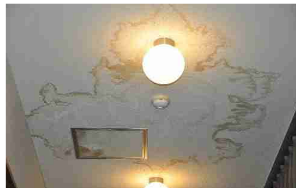
内部仕上の漏水跡
