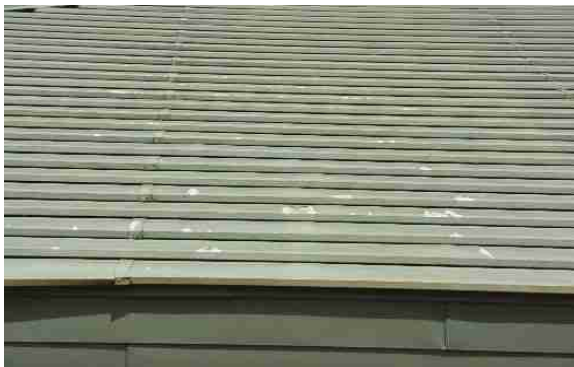
屋根金属板の塗膜剥離
