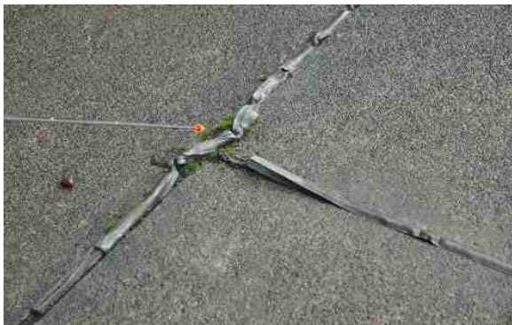
防水保護層伸縮目地の劣化・変形
