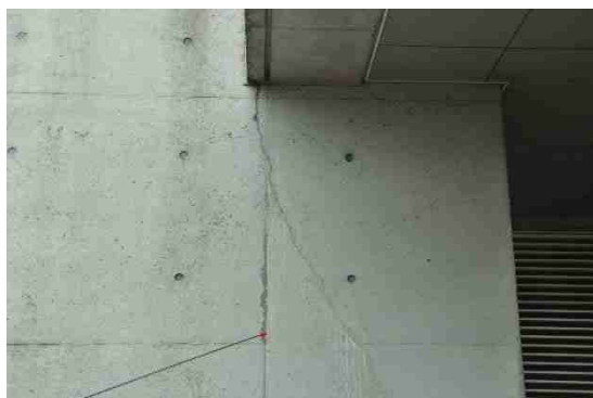
外壁のひび割れ・白華(多数)
