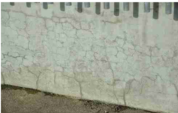
基礎のひび割れ（多数）
