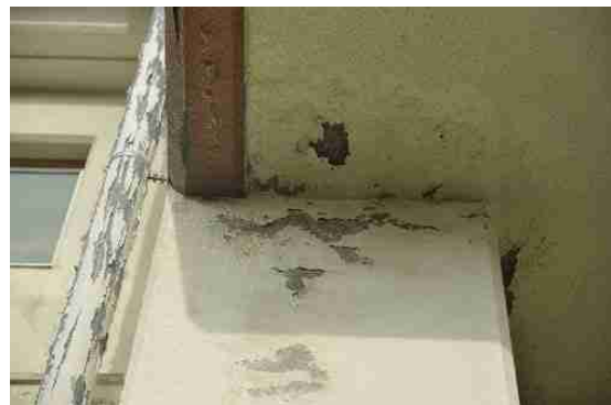
吹付塗材の劣化・剥離・剥落（多数）
