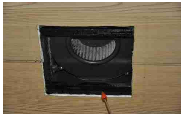
天井換気扇カバーの脱落
