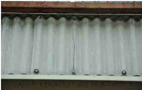
外壁スレート板の亀裂
