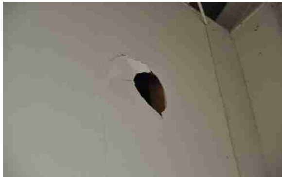
内壁ボードの破損
