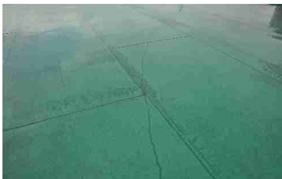
屋上シート防水の亀裂（多数）
