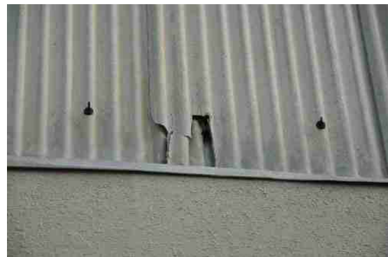
外壁スレート板の破損
