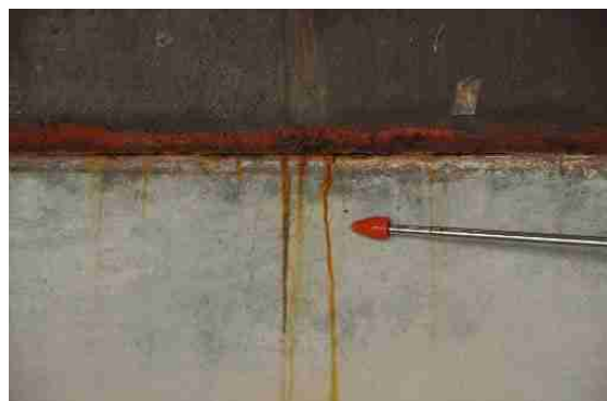
体育室スチール窓枠の発錆・腐食（全体）
