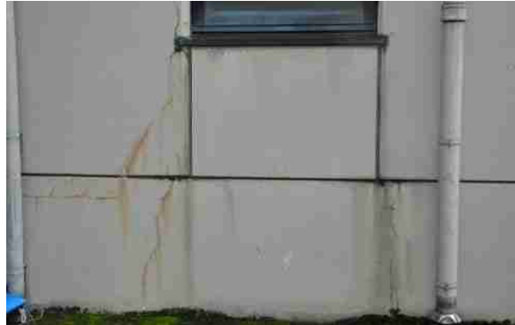
外壁のひび割れ・錆汁（全体多数）
