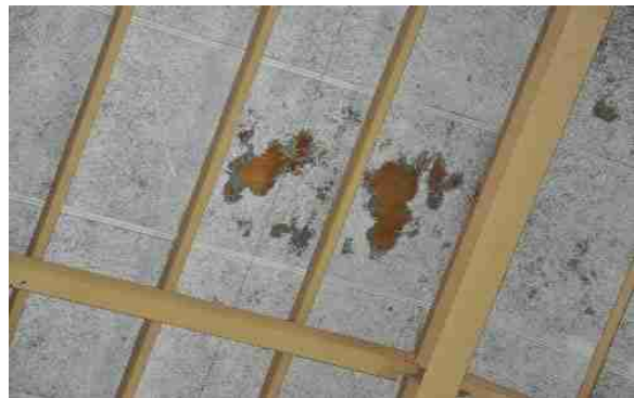
木毛セメント板の破損
