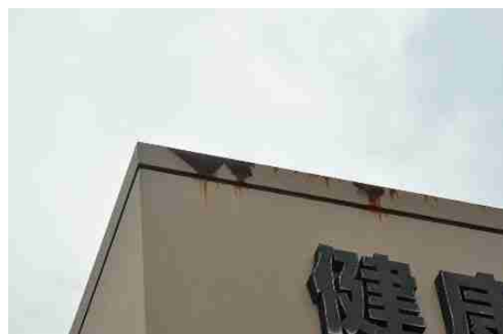
外壁金属パネルの腐食
