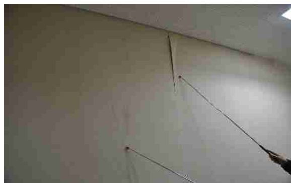
内壁クロスの剥れ・ひび割れ（多数）
