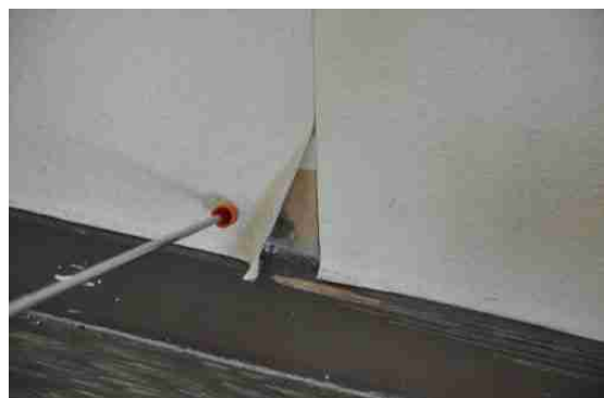
内壁クロスの剥がれ
