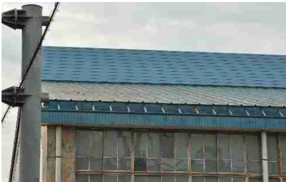
金属板葺の劣化・発錆
