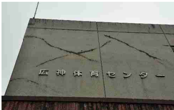
外壁の亀裂（全面全体）
