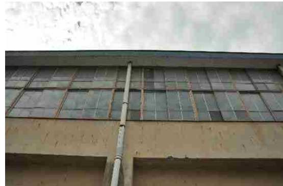
スチール窓枠の劣化・発錆
