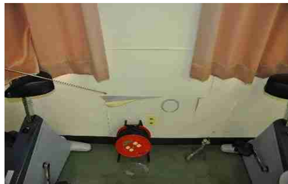
内壁クロスの剥がれ
