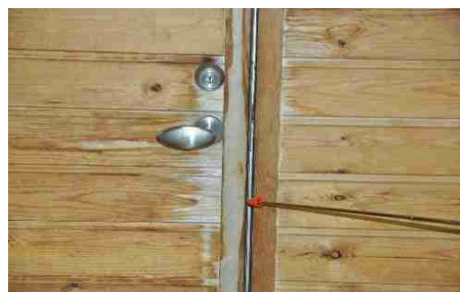
スチール扉の漏水跡
