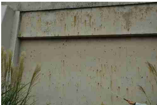
外壁のひび割れ・爆裂・錆汁（全体多数）
