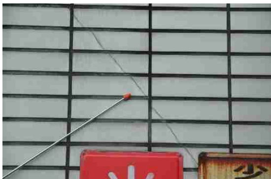
外壁タイルのひび割れ（多数）
