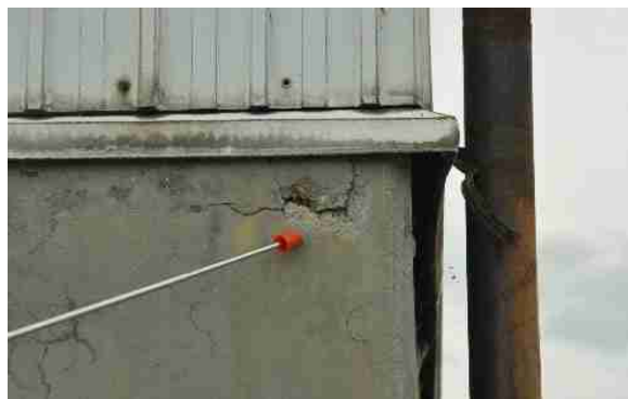
基礎のひび割れ・剥離・鉄筋発錆
