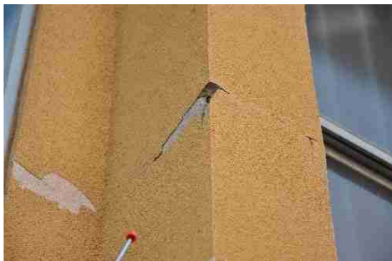
柱型のひび割れ・剥離・剥落（多数）
