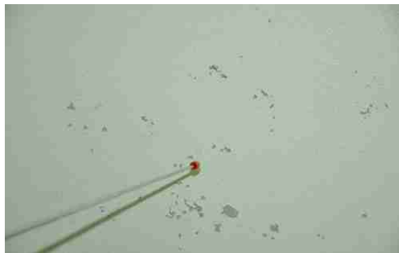
内壁吹付塗材の劣化
