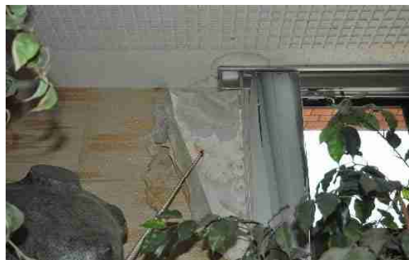
内壁クロスの剥がれ・雨漏り跡
