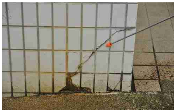
外壁タイルのひび割れ・破損
