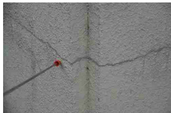
基礎のひび割れ（多数）
