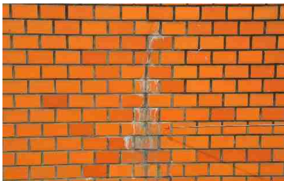
外壁のひび割れ・白華（全面）
