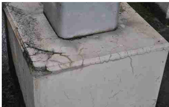
根巻コンクリートのひび割れ・剥落
