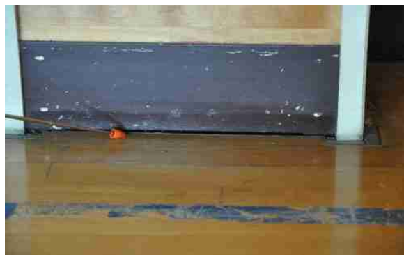
床と幅木の隙間（全体）
