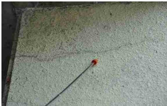
柱のひび割れ（多数）
