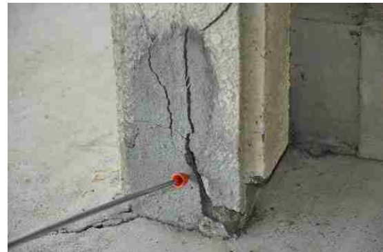
手摺り壁のひび割れ・剥離
