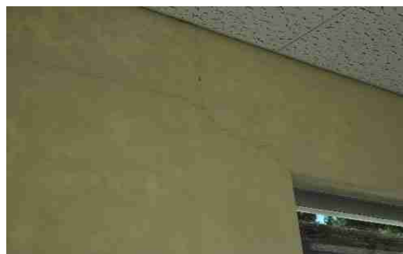
内壁のひび割れ（全体多数）
