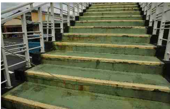
階段のひび割れ・錆汁（多数）
