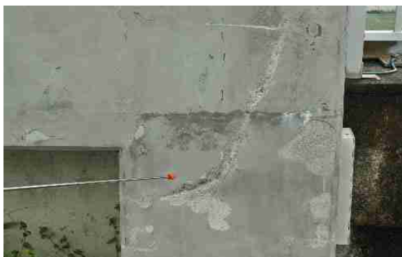
基礎のひび割れ・損傷
