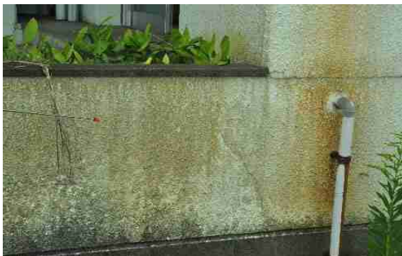
外壁吹付塗材の劣化・変色（全体）
