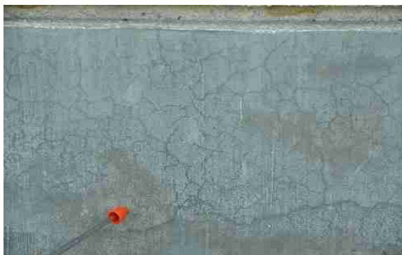
基礎のひび割れ（多数）
