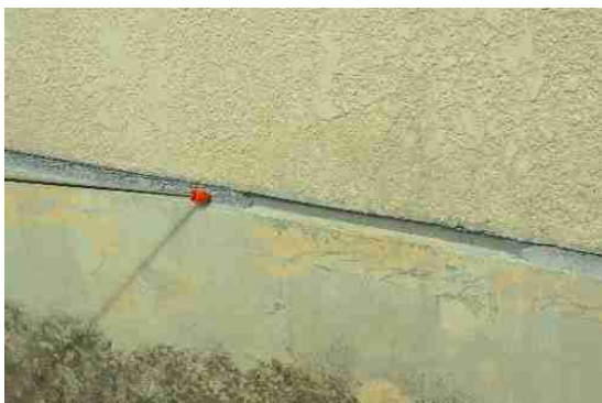
コーキング材の脱落
