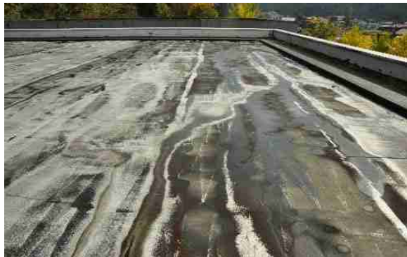
塗膜防水の経年劣化・汚れ付着（全体）
