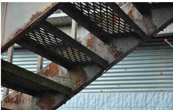
屋外避難階段の発錆・腐食
