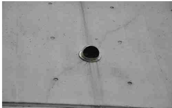
外壁のひび割れ
