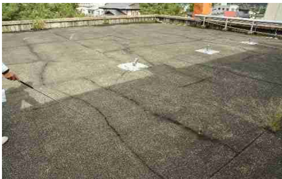
防水保護層のひび割れ（全体多数）
