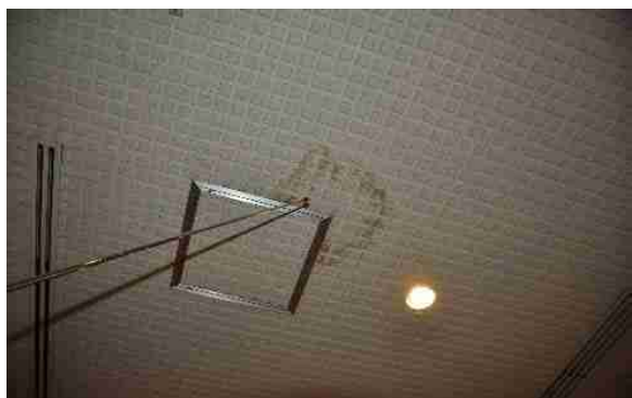
天井の漏水跡
