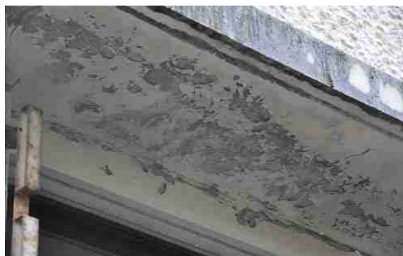
吹付塗材の劣化・剥落（全体）
