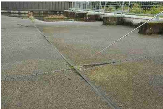
防水保護層伸縮目地の劣化・変形(全体)
