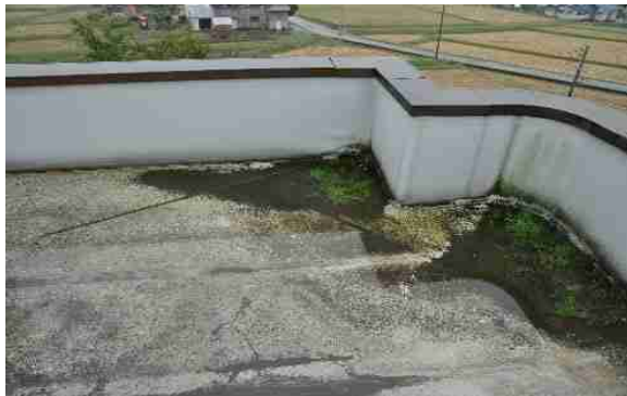
シート防水の劣化・ひび割れ・排水不良(全体)
