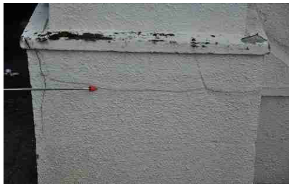
外壁・基礎のひび割れ
