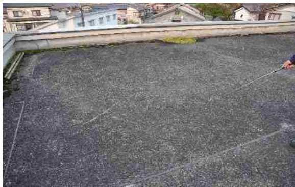
防水保護層のひび割れ
