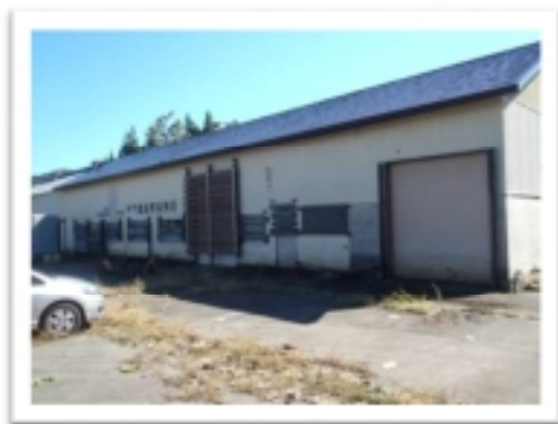
＜ 上条地区に設置した仮集積所 ＞
