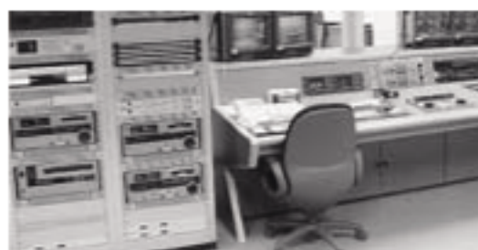
ケーブルテレビ調整室
