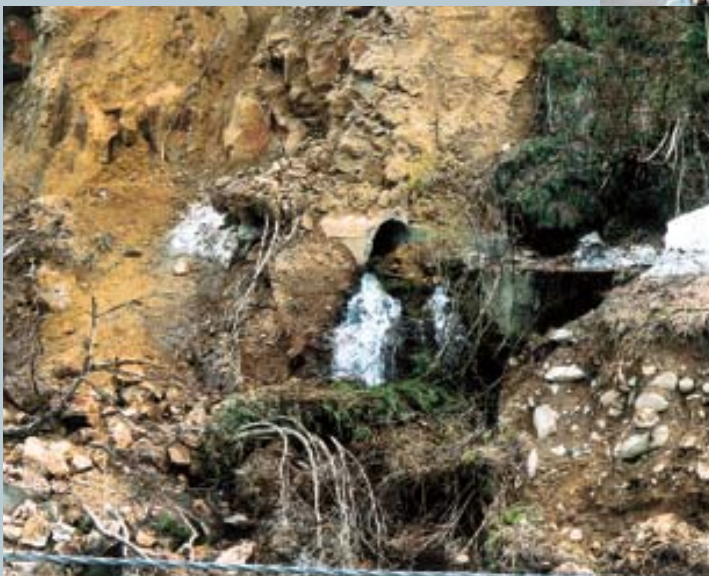
高倉地内水路破損
