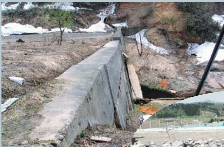
水沢砂防堰堤破損
