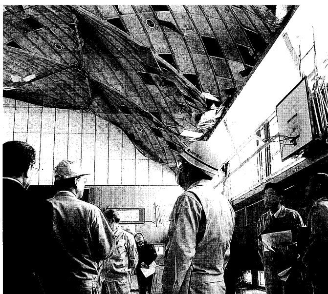
天井パネルが落下、甚大な被害を受けた堀之内中学校体育館
