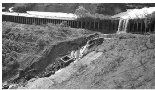
スノーシェッドの破損現場 (国道252号田子倉ダム付近)
