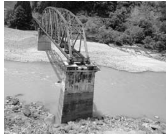
只見線の落橋現場
