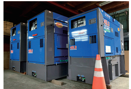
非常用発電機
